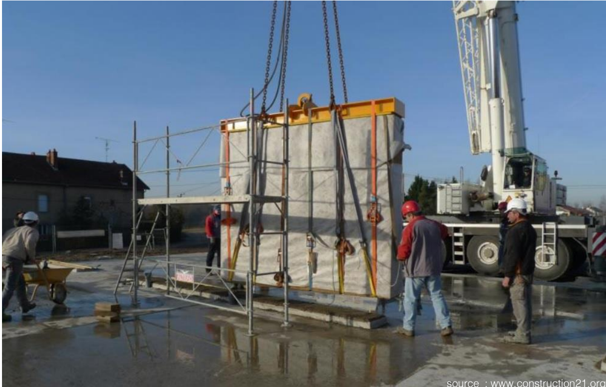
Mise en place du pisé préfabriqué, au chantier de la maison de santé à Badonviller.
